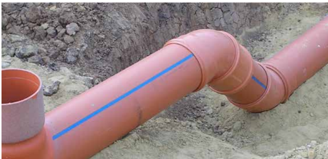
Фото № 22: Труба сборного коллектора в двух уровнях с равным уклоном
