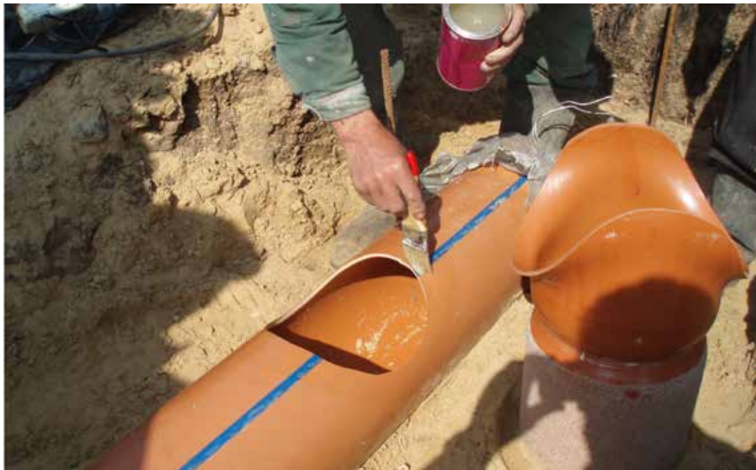
Фото № 10: Нанесение клеящего состава на поверхность трубы
