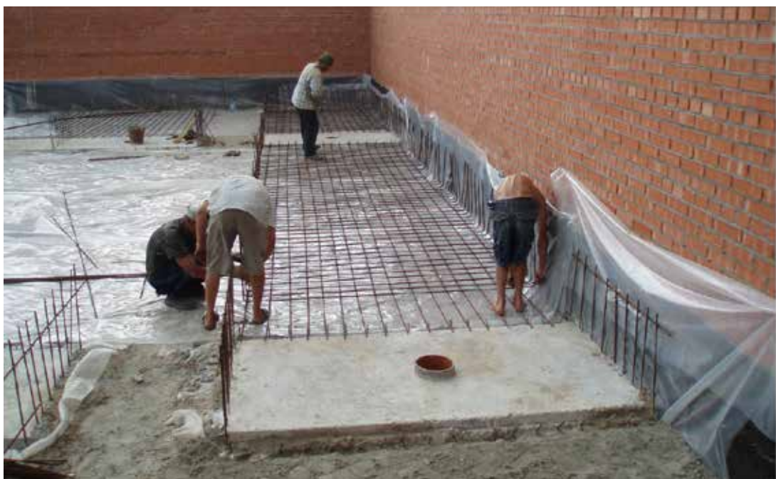
Фото № 20: Выступ сливной горловины из бетонного приямка – необходимо срезать
